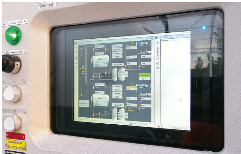
Рис. 3. Пост управления бункеровкой – резервный пост управления КБГС
