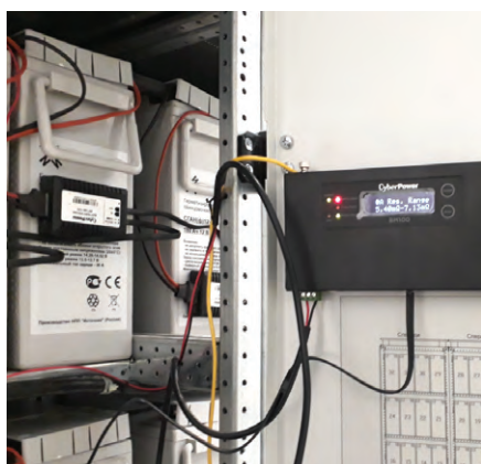
Рис. 3. Система BMS CyberPower, установленная на массив аккумуляторных батарей
