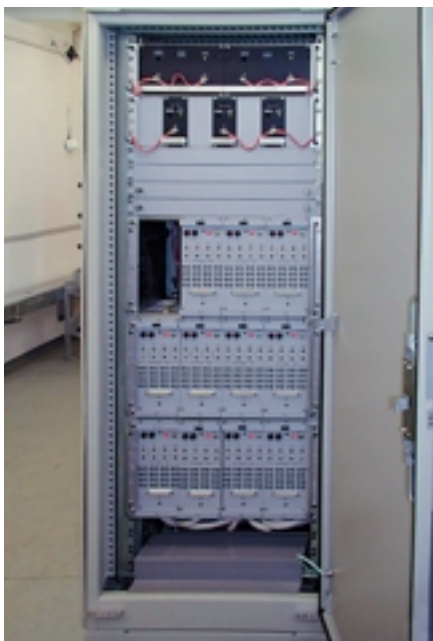
Рис. 8. Стойка СТФ аппаратуры ФМ-канала
