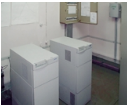
Рис. 10. Фрагмент оборудования системы электропитания СА с ИБП
