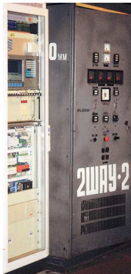
Рис. 5. Шкаф управляющей ЭВМ
