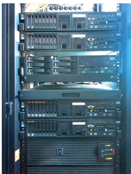
Рис. 4. Серверный шкаф рудника
