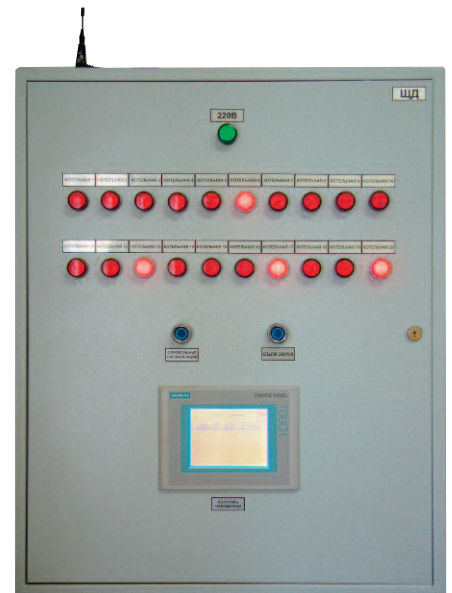
Рис. 3. Щит диспетчеризации, установленный в центральном диспетчерском пункте
