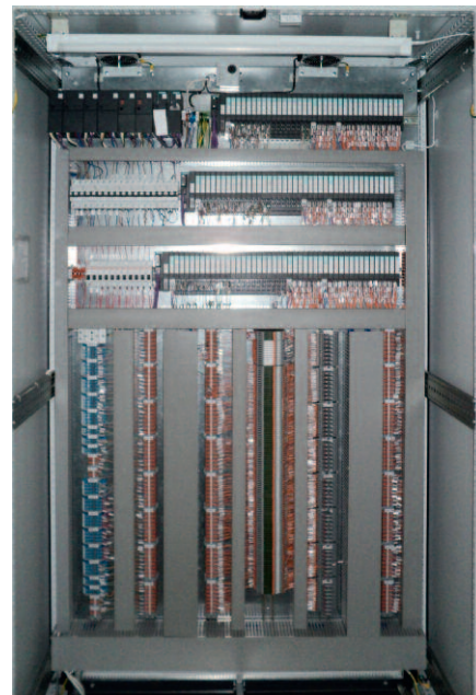
Рис. 3. Контроллерный шкаф АСУ ТП ГОТ К2
