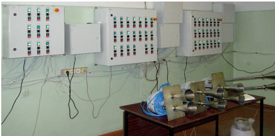
Рис. 3. Шкафы управления на этапе проведения испытаний
