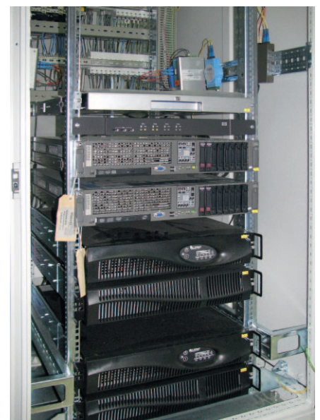
Рис. 7. Общий вид шкафа серверов СТМ
