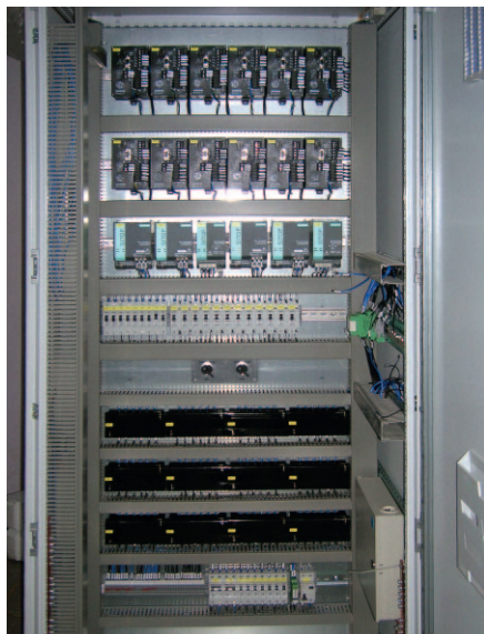
Рис. 3. Шкаф телеизмерений (вид спереди)
