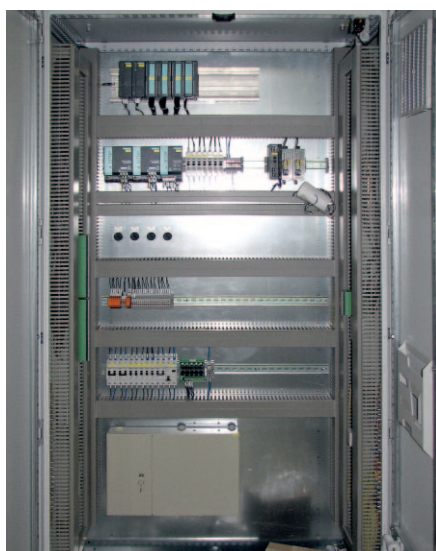
Рис. 4. Шкаф приёма телесигналов (вид спереди)
