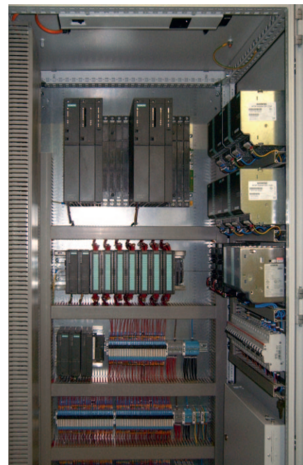
Рис. 2. Шкаф контроля и управления (ШКУ)
