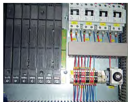
Рис. 7. Шкаф AD-D: установка автоматов защиты
