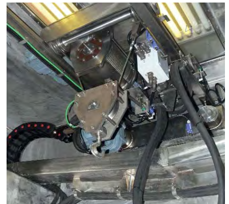
Рис. 2. Оборудование в технологической камере
