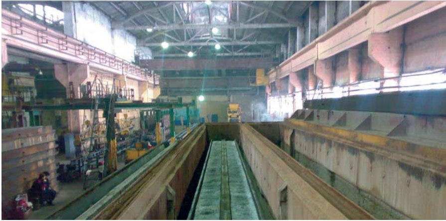
Рис. 2. Пропарочная камера (крышка снята, изделия загружены)
