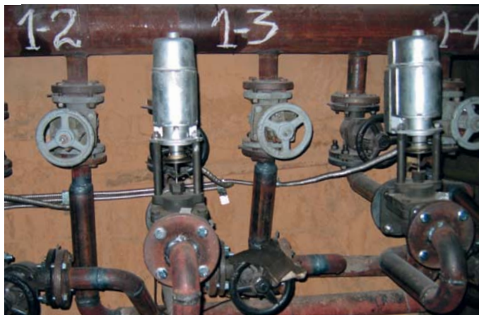
Рис. 4. Электроклапаны, установленные на паропроводе
