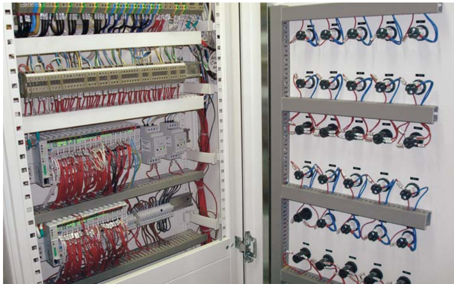
Рис. 7. Внешний вид шкафа локальной автоматики системы вентиляции
