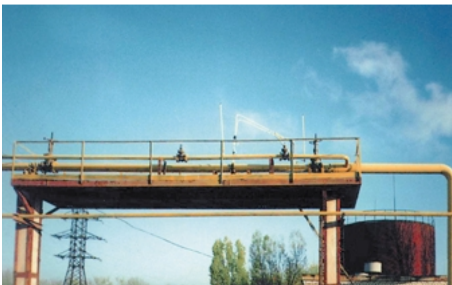
Расходомерное устройство системы учёта потребления газа, внедрённой на Губинихском сахарозаводе
