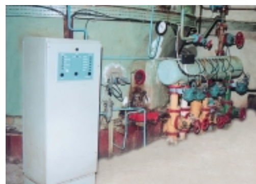
Датчики и исполнительные устройства системы автоматизации вакуум-аппарата
