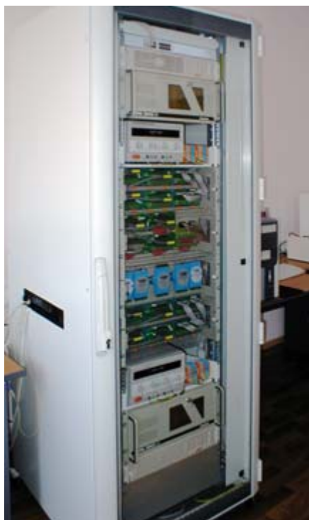
Рис. 2. Шкаф с устройствами комплекса
