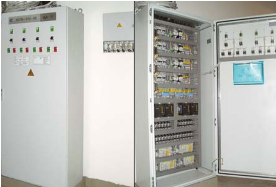
Рис. 2. Шкаф системы управления вентиляционной установкой
