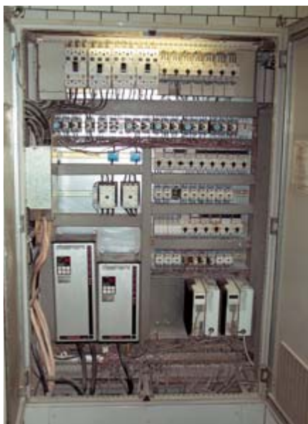
Рис. 4. Силовая секция шкафа управления
