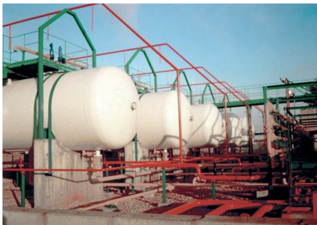
Рис. 1. Резервуарный парк базы хранения газонаполнительной станции
