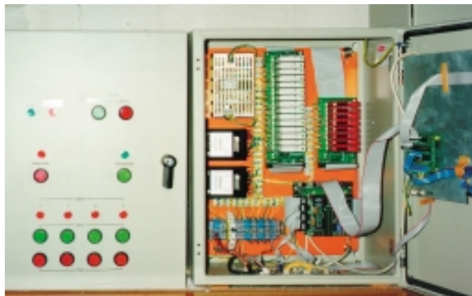
Размещение составных частей блока управления системы ЛСУ КНС на шасси шкафа
