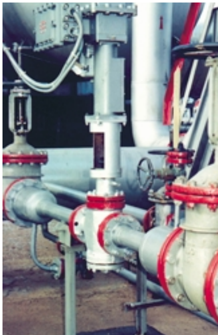
Рис. 4. Исполнительный механизм — электрифицированная задвижка
