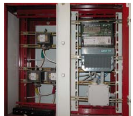
Рис. 3. Счётчик потребления электрической энергии лифтами и системой освещения
