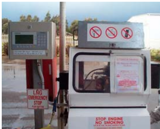
Панель TERMEХ в составе оборудования газозаправочной станции
