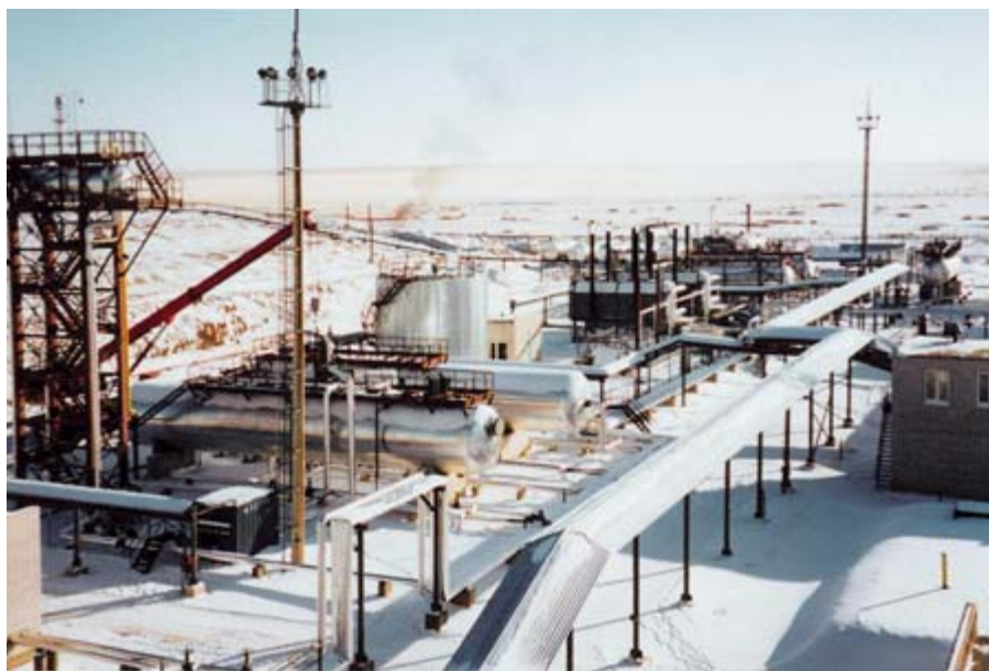
Рис. 1. Общий вид установки комплексной подготовки нефти
