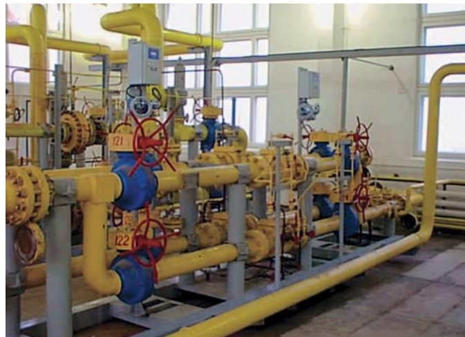
Газораспределительная станция, участок измерения расхода газа
