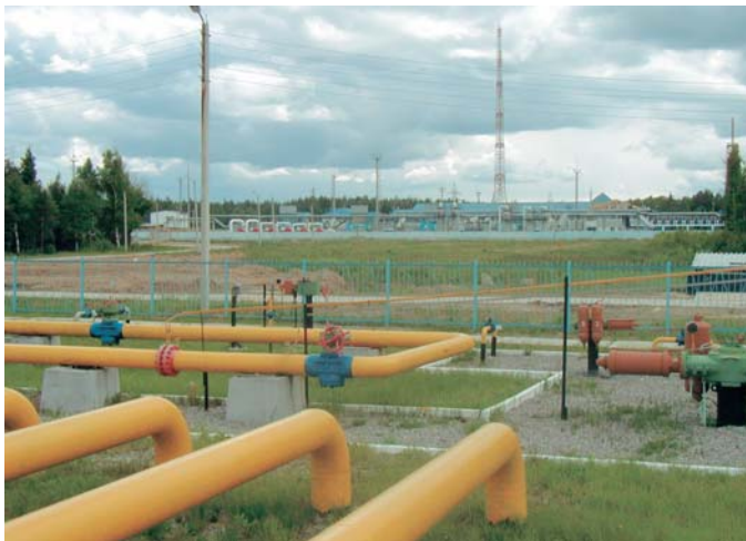
Вид на компрессорную станцию
